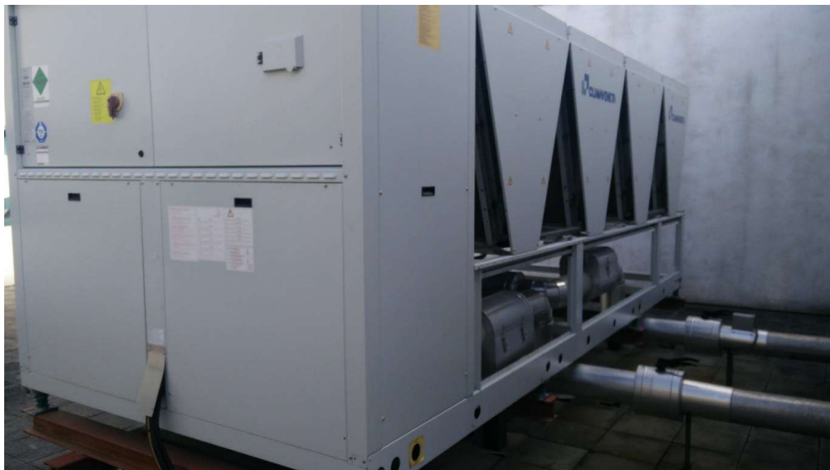
Refredadora CLIMAVENETA i circuit impulsió i retorn existents.
