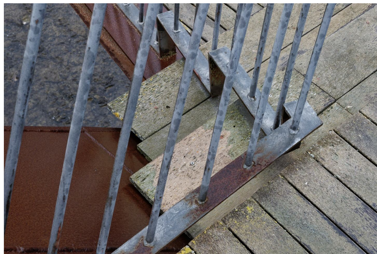
Imatge 5. Pintura de la barana malmesa pel rovell i envelliment de la tarima de fusta
