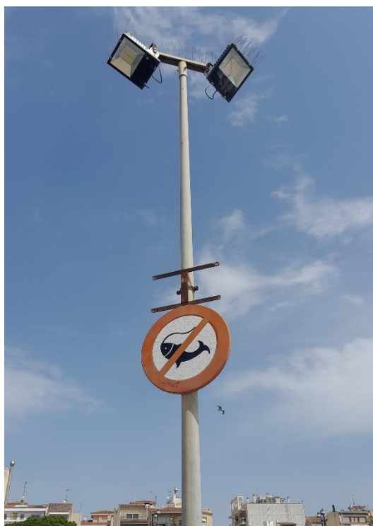
Figura 13 Detall de la lluminària existent
