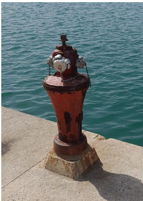
Imatge 3 Hidrant aeri existent
