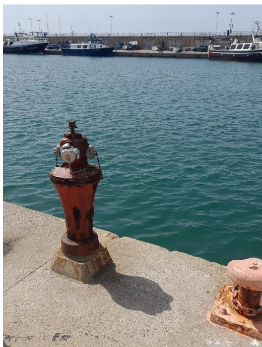
Figura 12 Hidrant aèri existent
