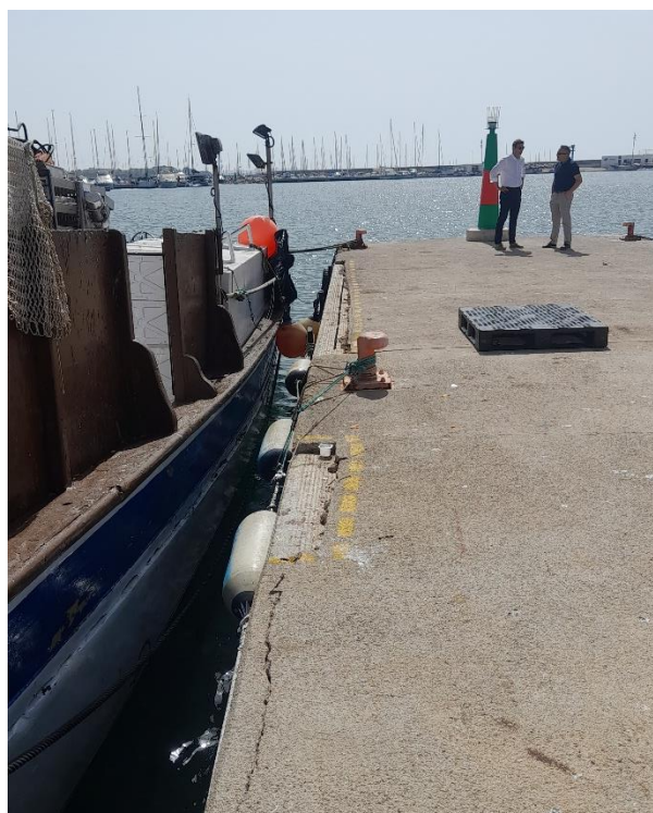
Figura 7 Diversos desperfectes en el cantell de l'espigó
