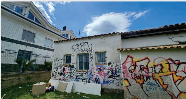
Detall façana posterior. Trànsit de tèrmits subterrànis
