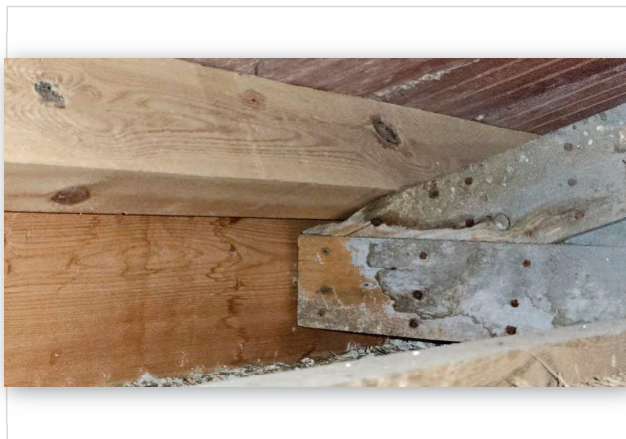
Estat de l'extrem del tirant -P4 a P3 -
