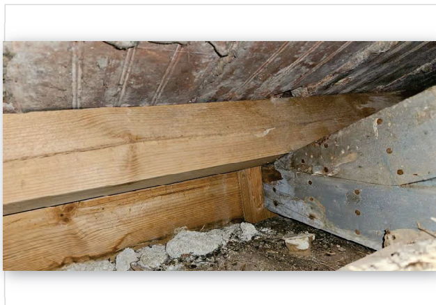
Estat de l'extrem del tirant -P5 a P4 nord -
