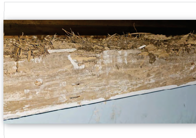
Danys produïts per tèrmits subterranis a perfil perimetral del fals sostre
