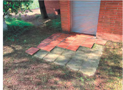
Paviments exteriors malmesos
