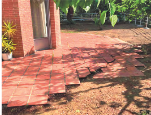
Paviments exteriors malmesos
