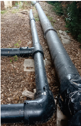
Figura 1. Imatge del tram inicial de les conduccions, on hi ha el punt de connexió amb el dipòsit 3 on es pot apreciar l'espai que hi ha entre el tub de fosa i el límit de la parcel·la.
