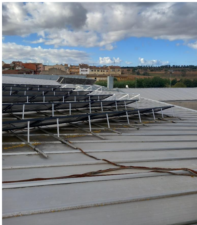
Foto 3: Filtracions de Coberta – Junta de prefabricat
