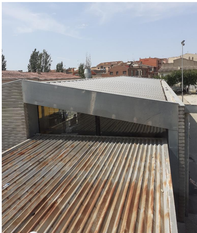
Foto 4: Filtracions de Coberta. Humitat a la placa
