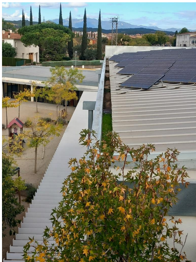
Foto 2: Filtracions de Coberta
