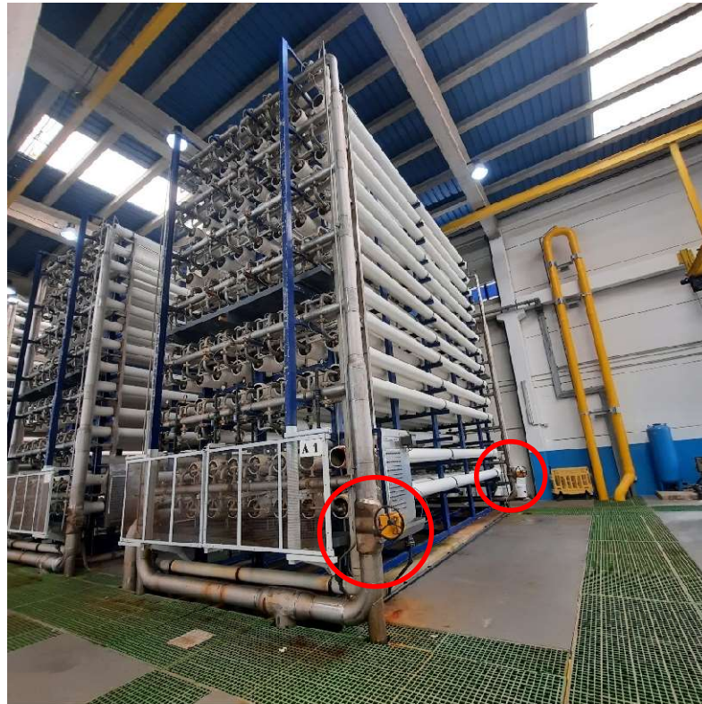
Vista de bastidor i localització de vàlvules 8" i 6"
