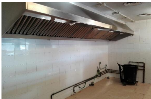
9 campanes extractores i espai per fogons
