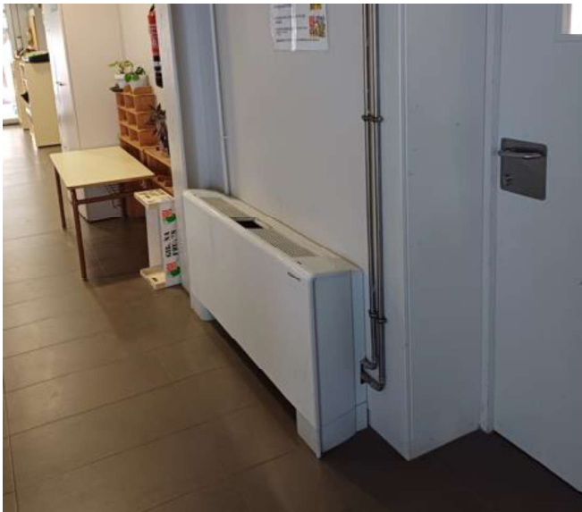
Figura 1. Fancoil existent a la planta baixa.
