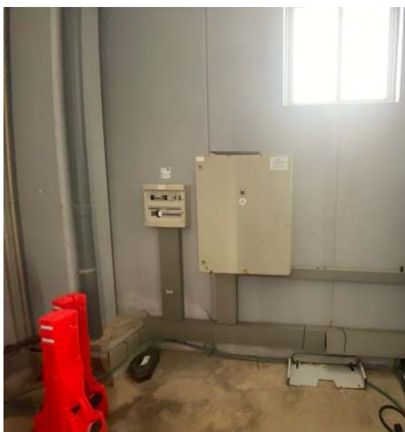
Fotografia 7: Quadres de serveis auxiliars
