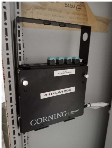
Fotografia 8: Caixa de fibra òptica a mantenir
