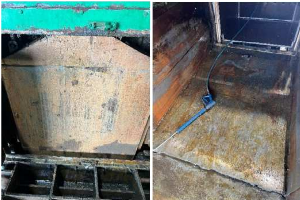
Fig. 1.- Estat actual de la porta i del túnel de sortides de les bales de RSU.
