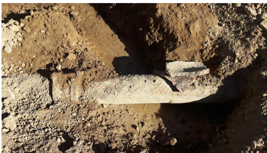
Danys a la canonada de fibrociment, descoberta i trencada
