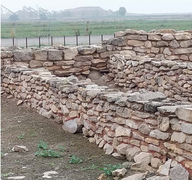
MURS DESCALÇAT – FALTA DE 2 O 3 PEDRES
