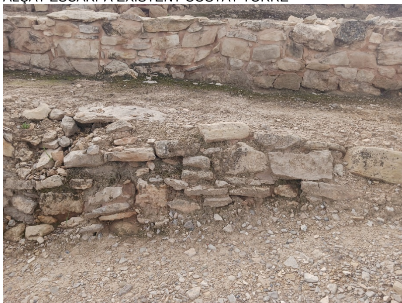
ALÇAT ESCARPA COSTAT ESQUERRA DE LA RAMPA.
