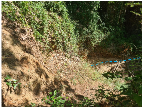
Terraplè sobre el pont del Torrent Can Torres de la Mata (punt JM14) amb indicis de degradació superficial. En blau el traçat del fons del torrent.
