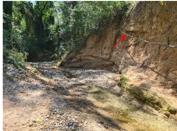
Escarpament del marge dret del Torrent de Can Cairot (punt JM26) amb la canonada i cable elèctric penjant a mitja alçada, mirant aigües avall.
