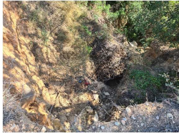
Capçalera del torrent secundari entre les vinyes del Montardit i la Vinya del Toni de la Riba (punt JM11). Vista superior des de la capçalera amb indicis d'activitat.
