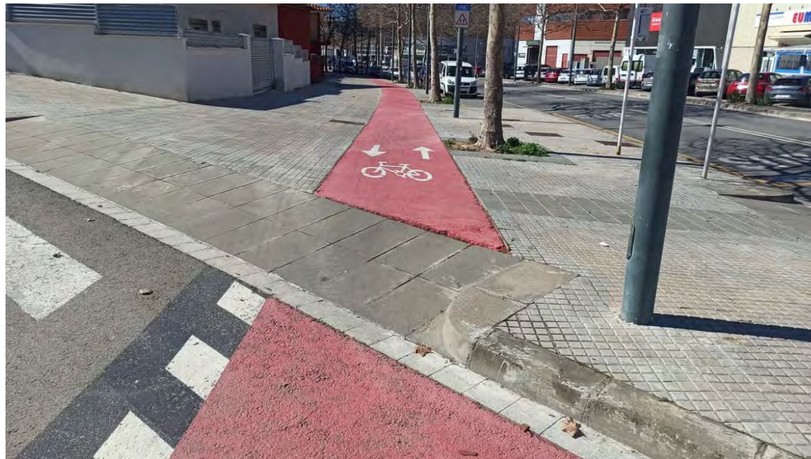
Figura 12. Guais de peces prefabricades de formigó de 60x40cm existents
