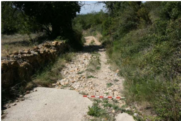
3.2 El tub de pas, sota carretera, vesa l'aigua al camí i arrastra les terres fins al barranc de Serret.
