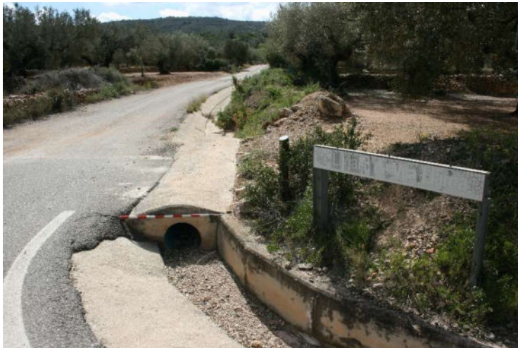
5.6 Les terres i graves que baixaven per la cuneta van omplir els tubs dels accessos als bancals.
