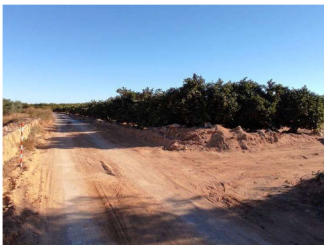
1.3 Part baixa del camí amb sortida de les aigües del bancal de tarongers. Aquest punt és una fondalada que no deixa sortir les aigües. Es preveu l'excavació d'una cuneta vora el marge dels tarongers fins el barranquet al final del bancal.
