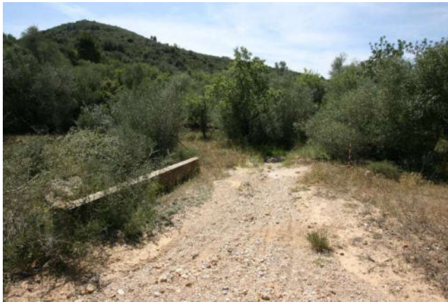
3.5 Els aiguats van fer caure la barana lateral del pont (a la dreta de la fotografia).
