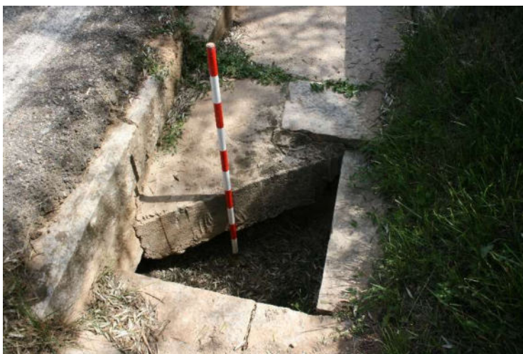
5.8 El sífó, està prop al colapse donat que acumula terres i es va reduint el pas. S'ha de netejar.
