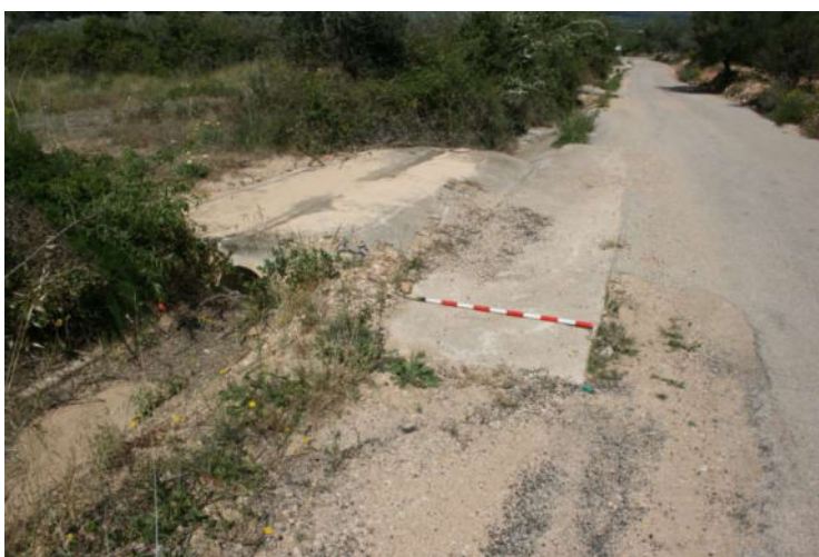
5.2 Els accessos als bancals provoquen un estretament de la cuneta. L'aigua que no pot passar, salta i erosiona el paviment. En aquesta imatge ja es veu una zona reparada.
