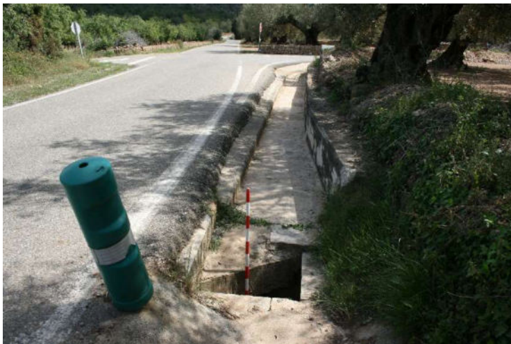
5.7 La cuneta vesa les aigües a un sífó que creua la carretera de Godall a Ulldecona. S'ha de netejar.
