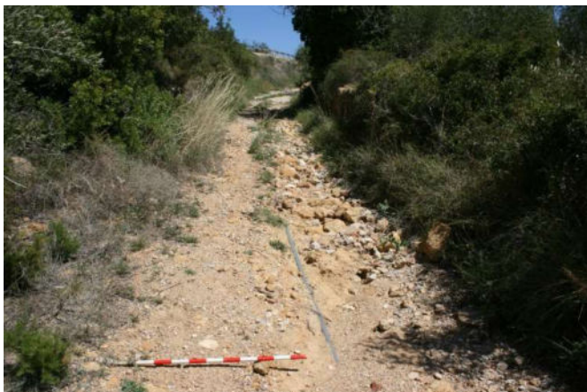
3.3 L'erosió del camí ha deixat el tub d'aigua potable al descobert.
