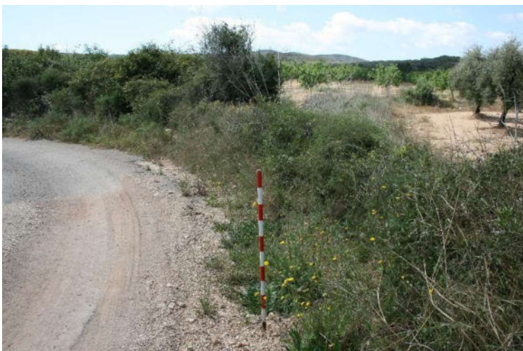
4.5 Cuneta plena de terres i vegetació. S'ha de netejar i recuperar la seva funcionalitat.
