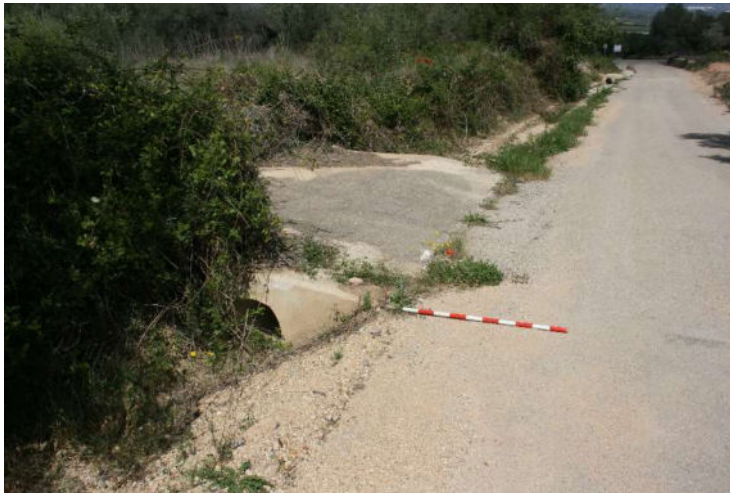
5.3 Els accessos fan de tap i les aigües salten sobre el paviment.
