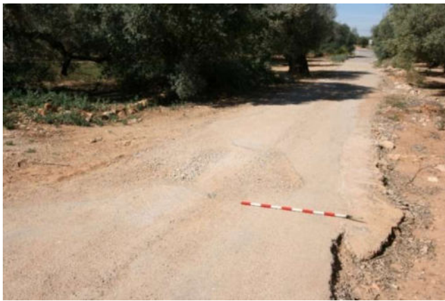
2.1 Camí desfet per les aigües que baixaven del bancal de l'esquerra. S'ha de tallar el paviment actual i fer-hi una llosa de formigó armat i uns cavallons per canalitzar el pas de l'aigua.
