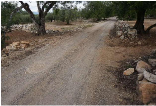
1.7 El bancal més alt aboca les aigües i desfà el paviment. Es preveu fer un pas formigonat.
