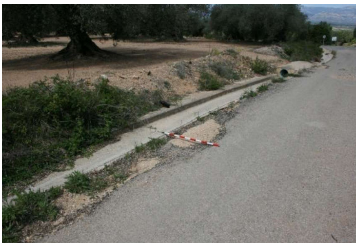
5.5 El paviment asfàltic està desfet a la junta amb la cuneta, per l'erosió de les aigües. S'ha de formigonar.
