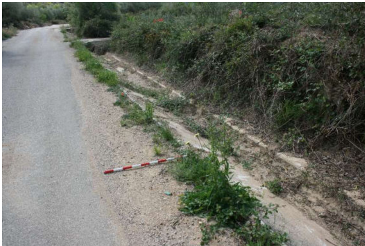
5.4 La cuneta, poc fonda, plena de terres i vegetació, facilita que l'aigua surti desfeti la junta entre asfalt i formigó.
