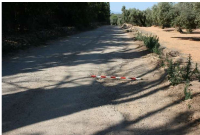
2.2 Clots al camí provocats per l'aigua de pluja que vesaven del bancal de l'esquerra. S'ha de tallar el paviment afectat en un rectangle de 10x1,5 metres i s'ha de formigonar fins les pedres del marge, per canalitzar el pas de l'aigua.
