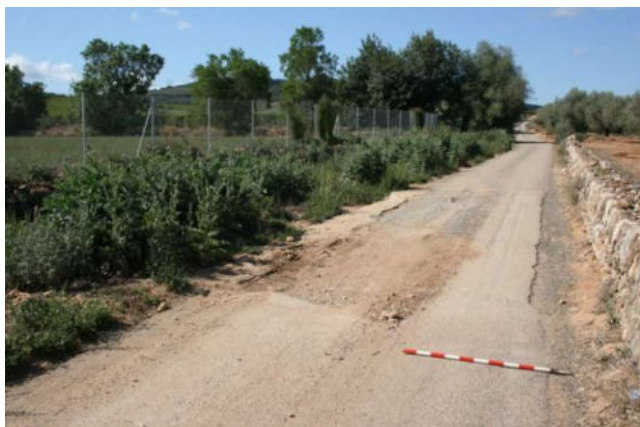
1.2 Camí malmès per l'erosió de les aigües al desbordar el barranquet.
