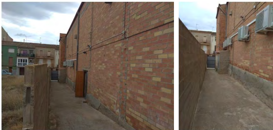
Elements penjats a la façana lateral (aparells AACC, focs, sanejament pluvials...)
