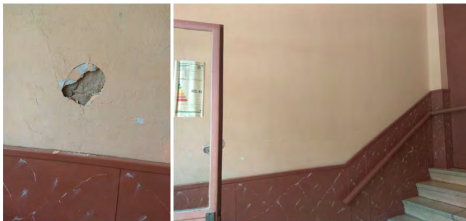
Patologia en la paret mitjanera, recobriment bufat
