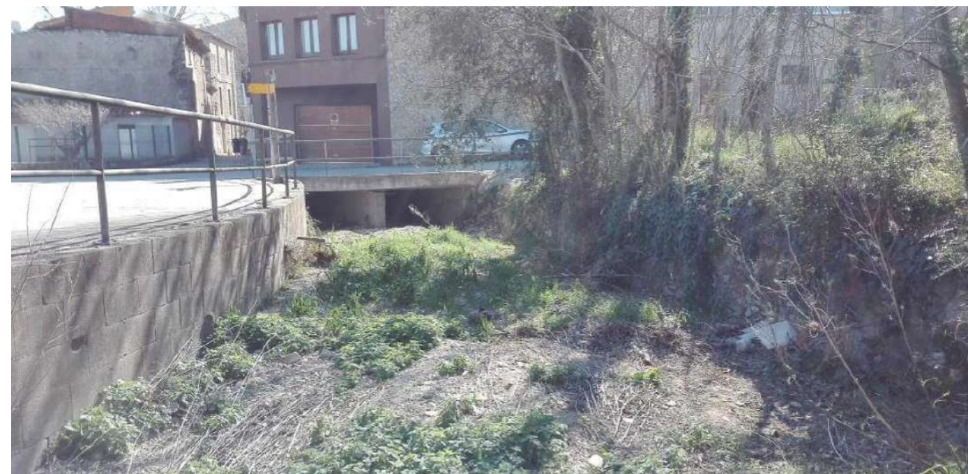
Figura 53. Imatge estat actual entrada torrent de Can Fuster.
