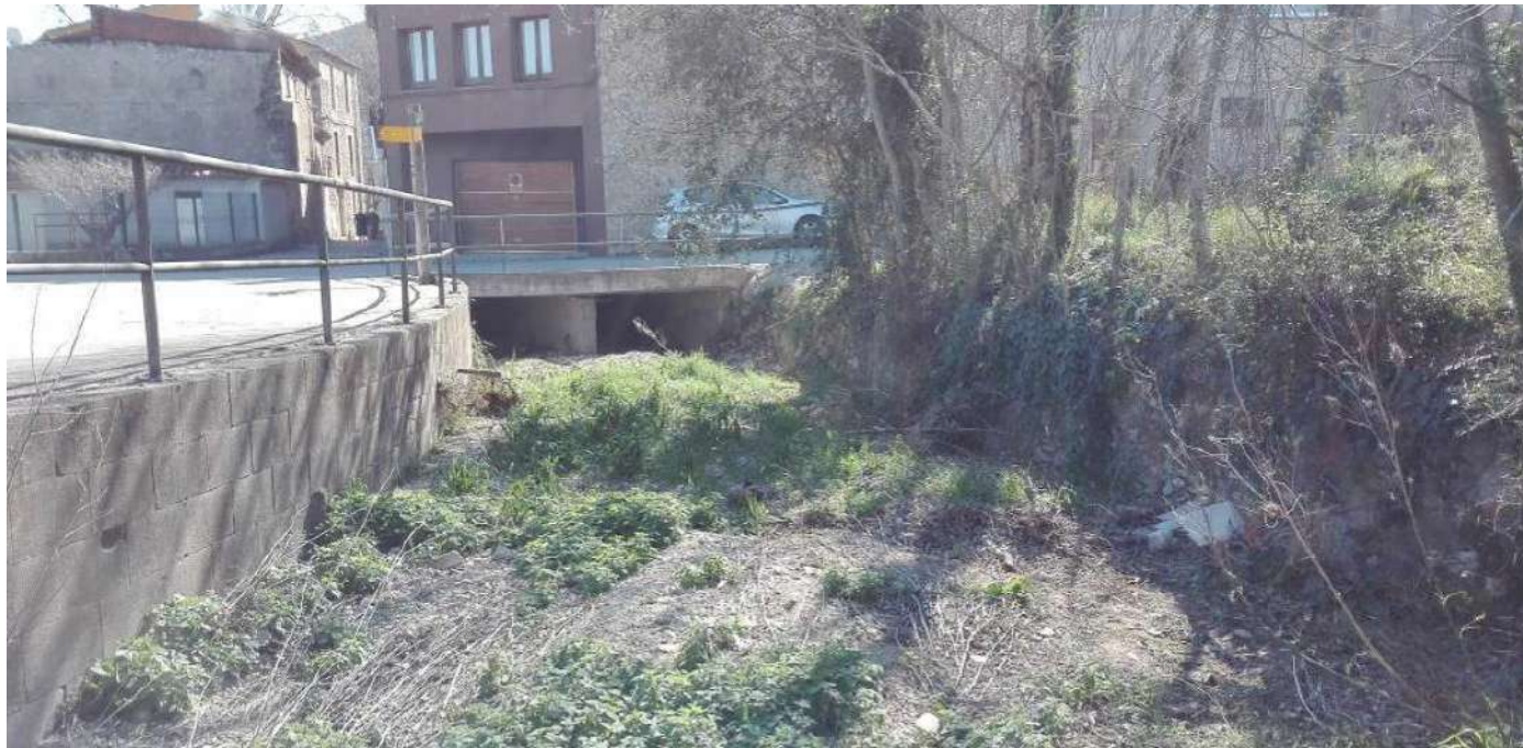
Figura 25. Imatge estat actual entrada torrent de Can Fuster.
