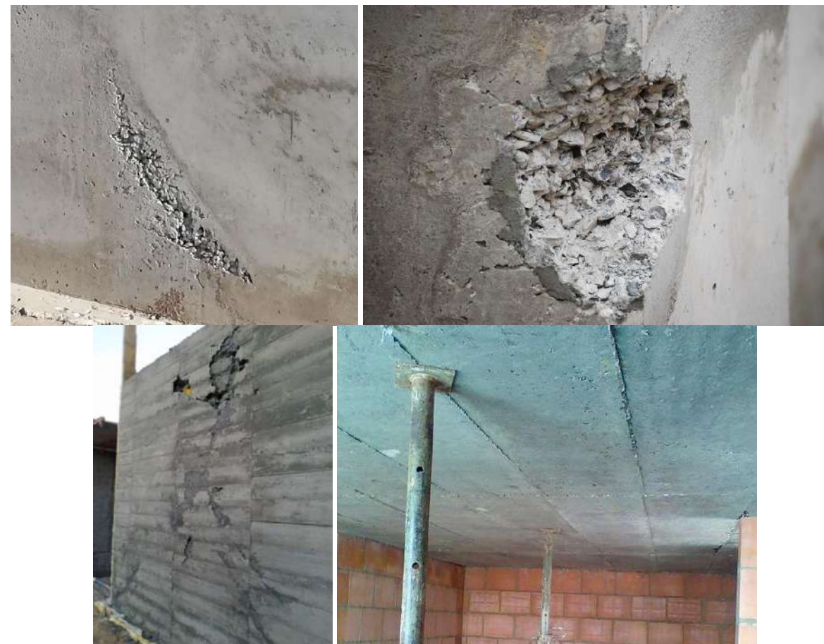
Figura 50. Diferents tipus de defectes en el formigó. Font: Pròpia / Curs MOOC - Introducción a los encofrados y las cimbras en obra civil y edificación.
