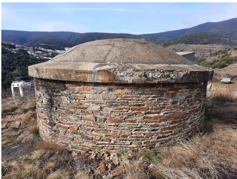
FOTO 5 – Vista del dipòsit d'Albet - Poble.
