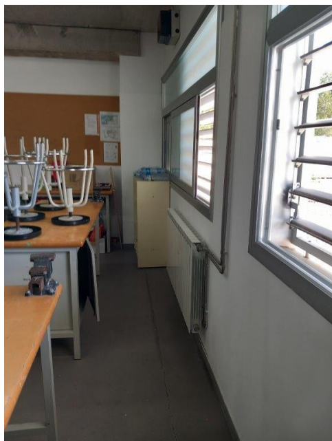
Esquerda en zona junta dilatació Gimnàs (Laboratori) (1)
