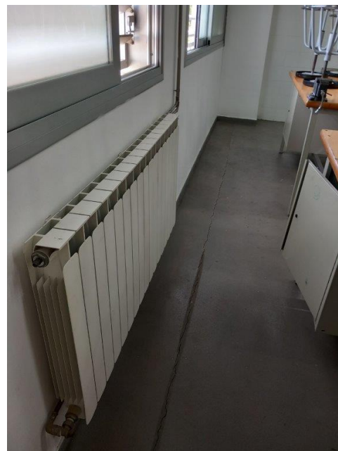
Esquerda en zona junta dilatació Gimnàs (Laboratori) (2)
