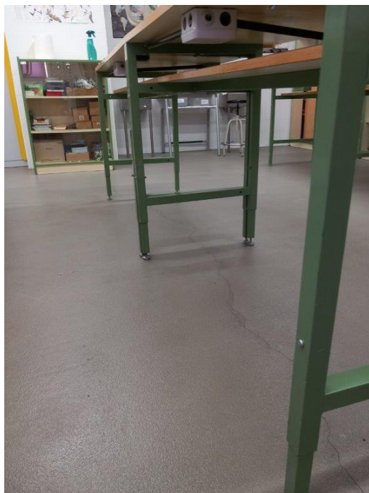
Fissures en revestiments (paviments) (1)
