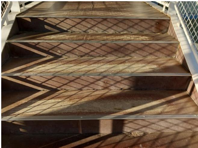
Graons amb degradació de la superfície.
