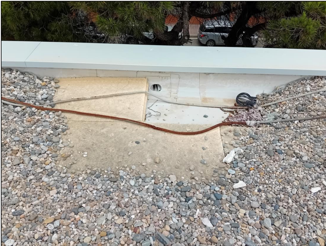
Fotografia de coberta a on s'han detectat filtracions. Bunera amb impermeabilització en mal estat (3)
