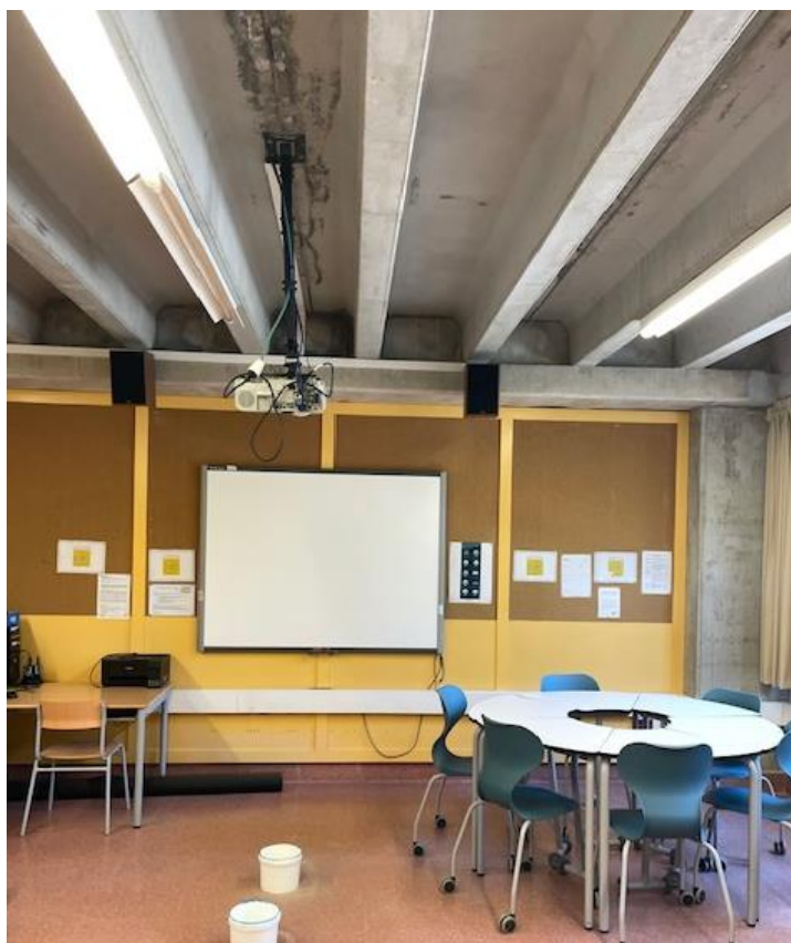
Danys interiors a planta primera deguts a filtracions (3).
