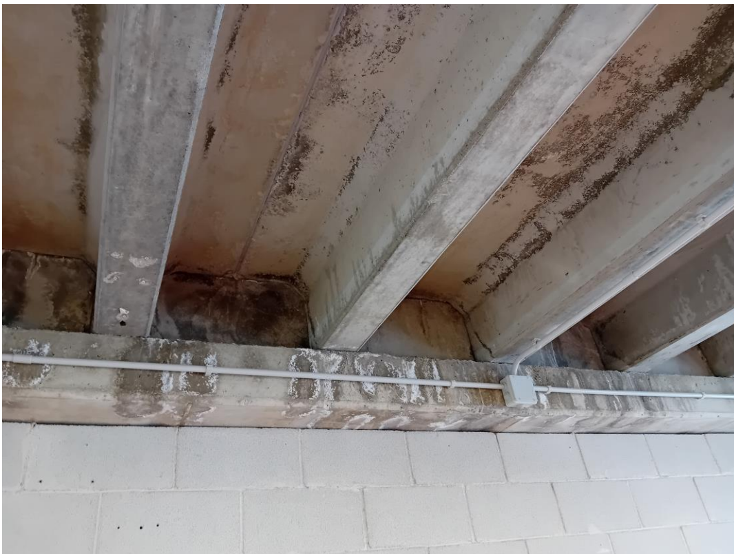
Danys interiors a planta primera deguts a filtracions (2).
