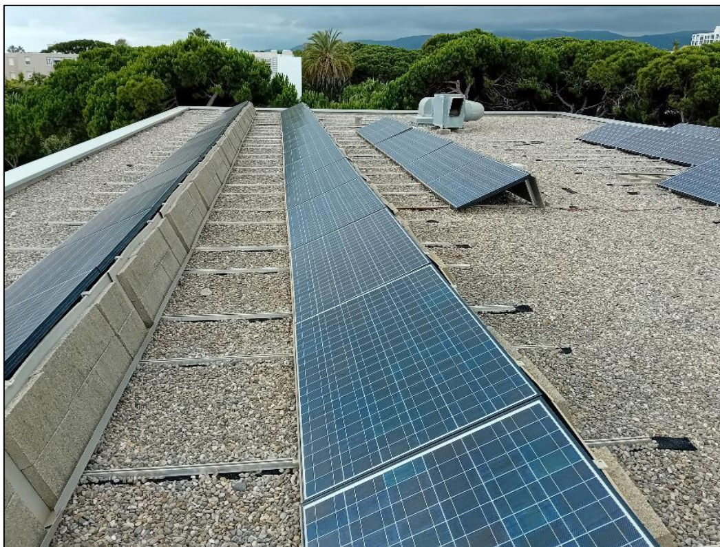
Fotografia de coberta a on s'han detectat filtracions d'aigua a l'interior de l'edifici (1)
