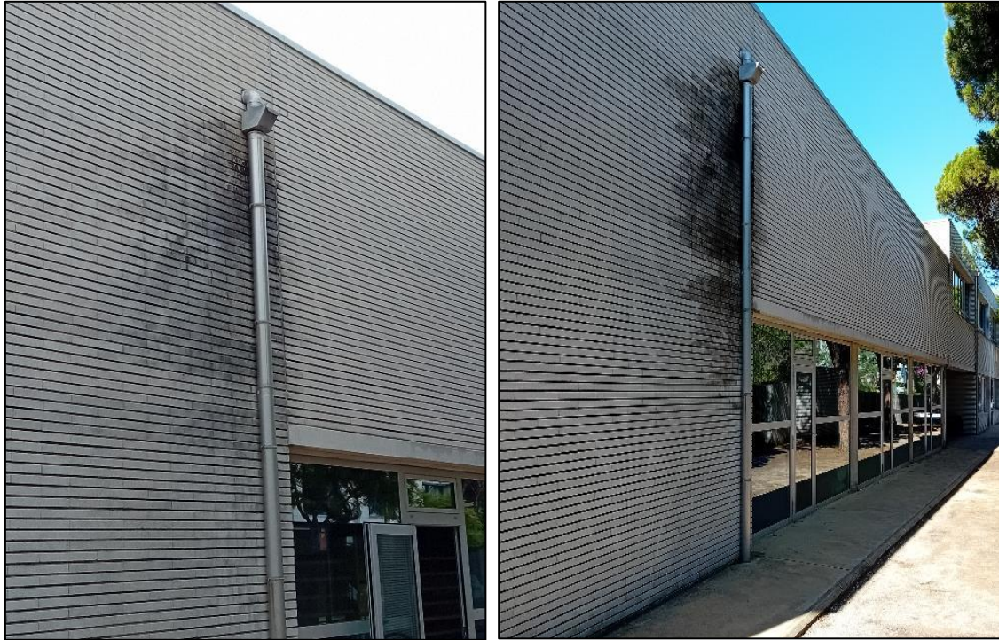
Conductes de pluvials a façana en mal estat.
