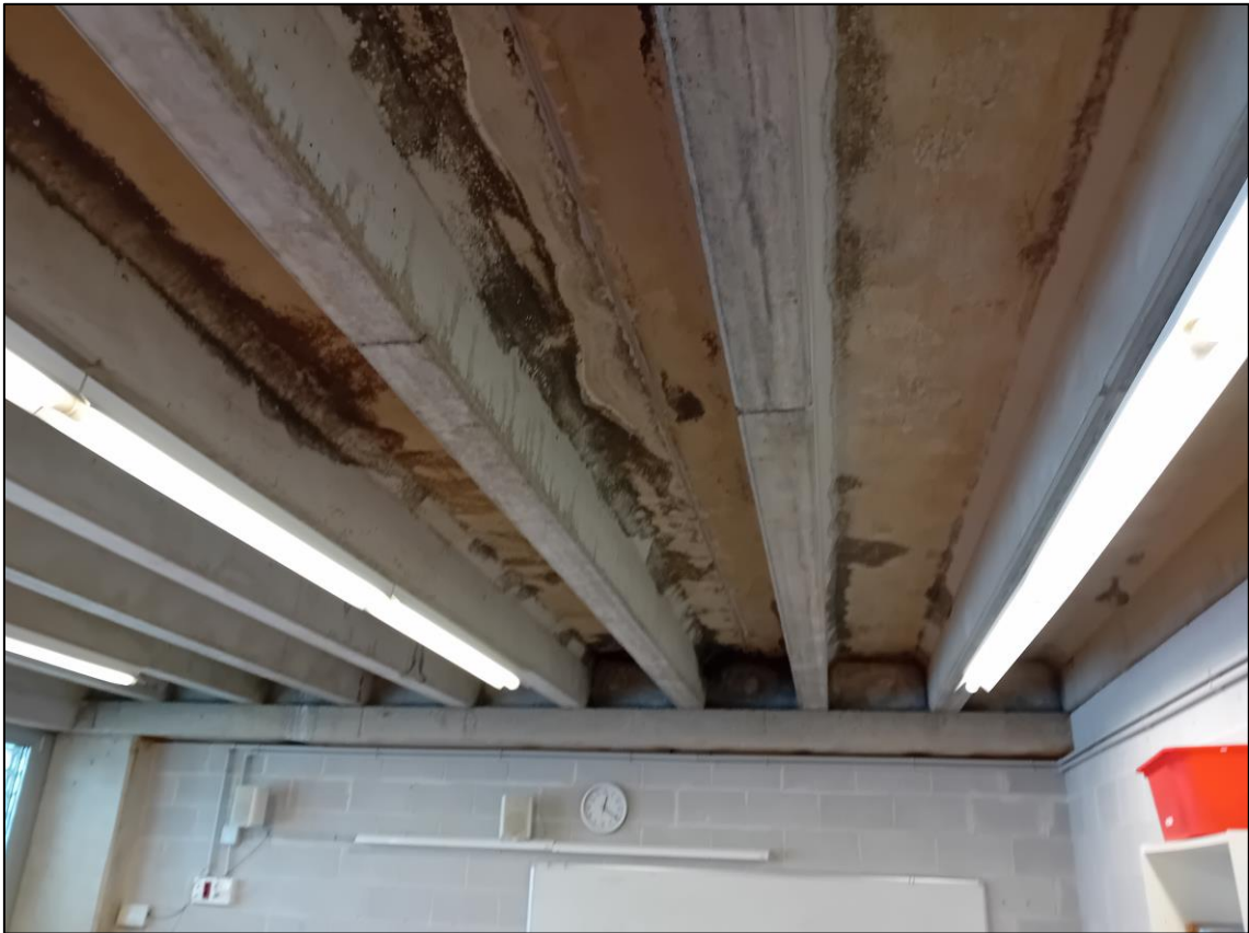
Danys interiors a planta primera deguts a filtracions (1).
