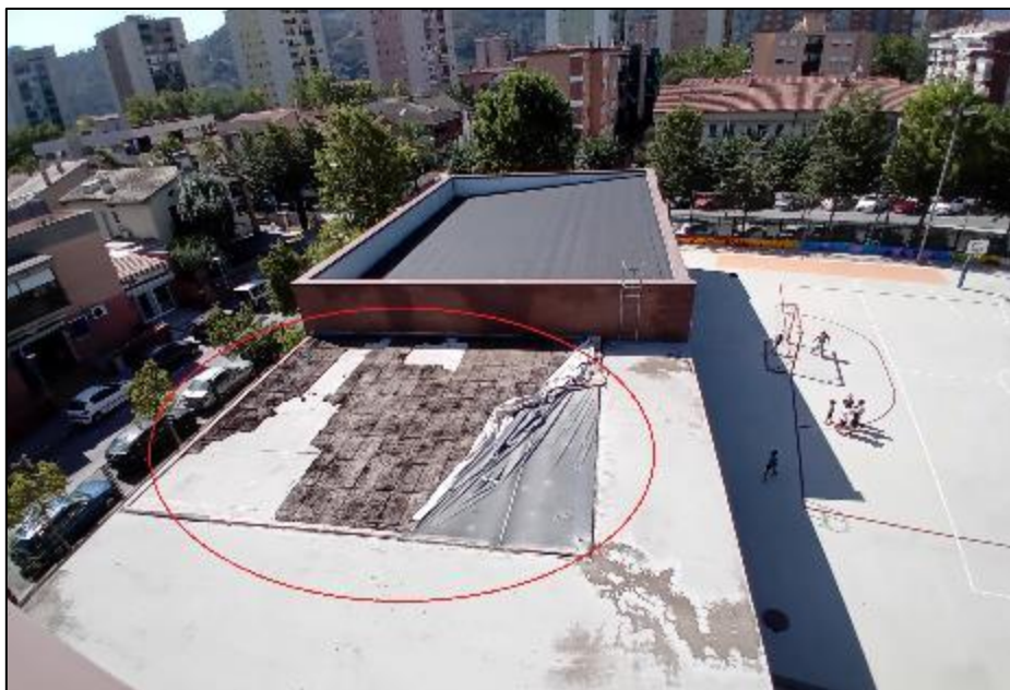
Danys a la impermeabilització de la coberta de vestuaris i porxos
