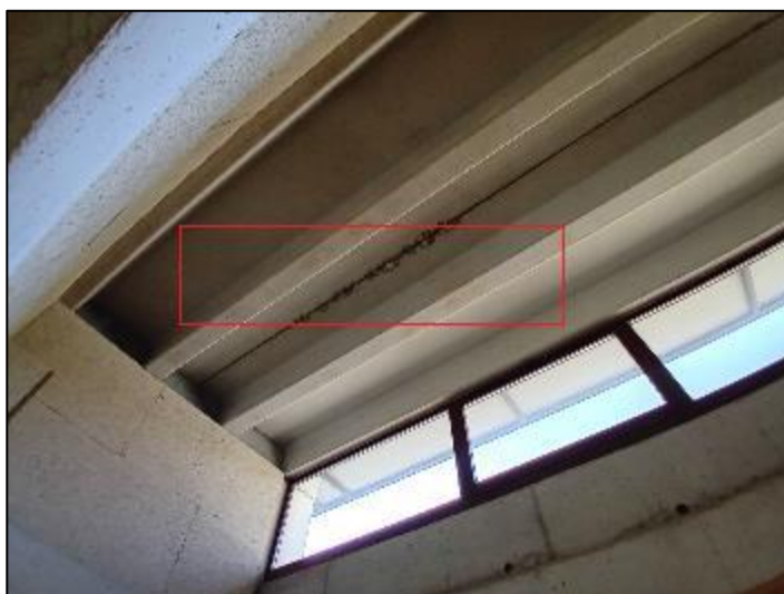
Filtració a les aules d'infantil
