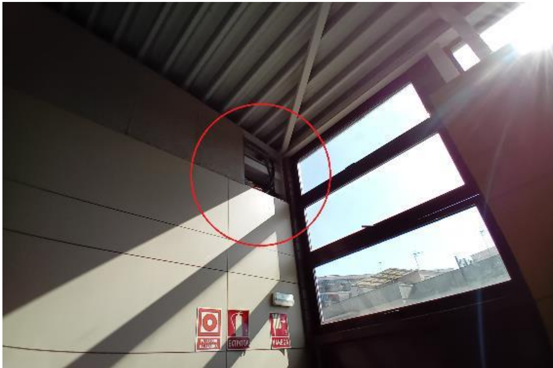
Danys interiors per filtracions poliesportiu.
