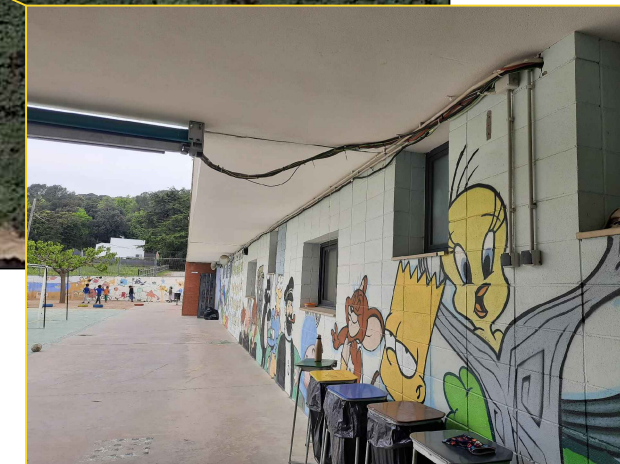
Zona de pas del cablejat cap a l'interior de l'edifici
