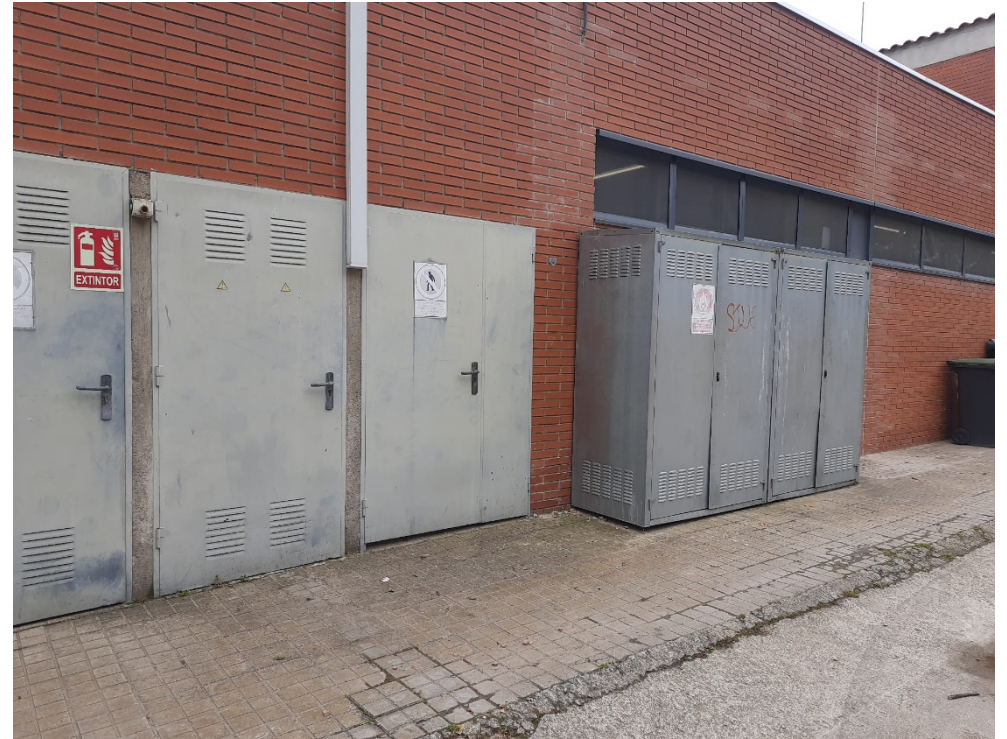
Il·lustració 6: Zona prevista per a la instal·lació de la nova TMF10. Zona nord del CEIP L'Estelada.
