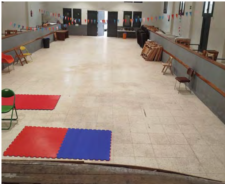
Vista del paviment actual amb les marques d'humitat.
