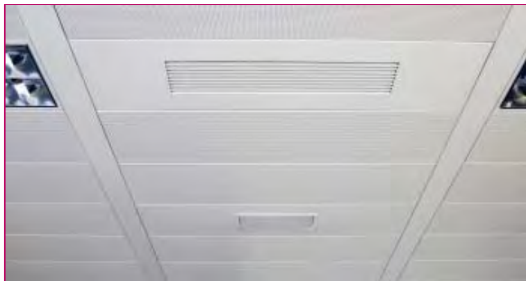
31-1 integrada en placa de falso techo
