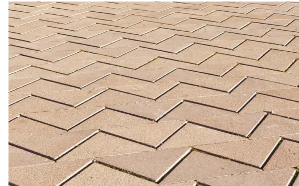
paviment permeable 'tri' al parc central de nou barris
