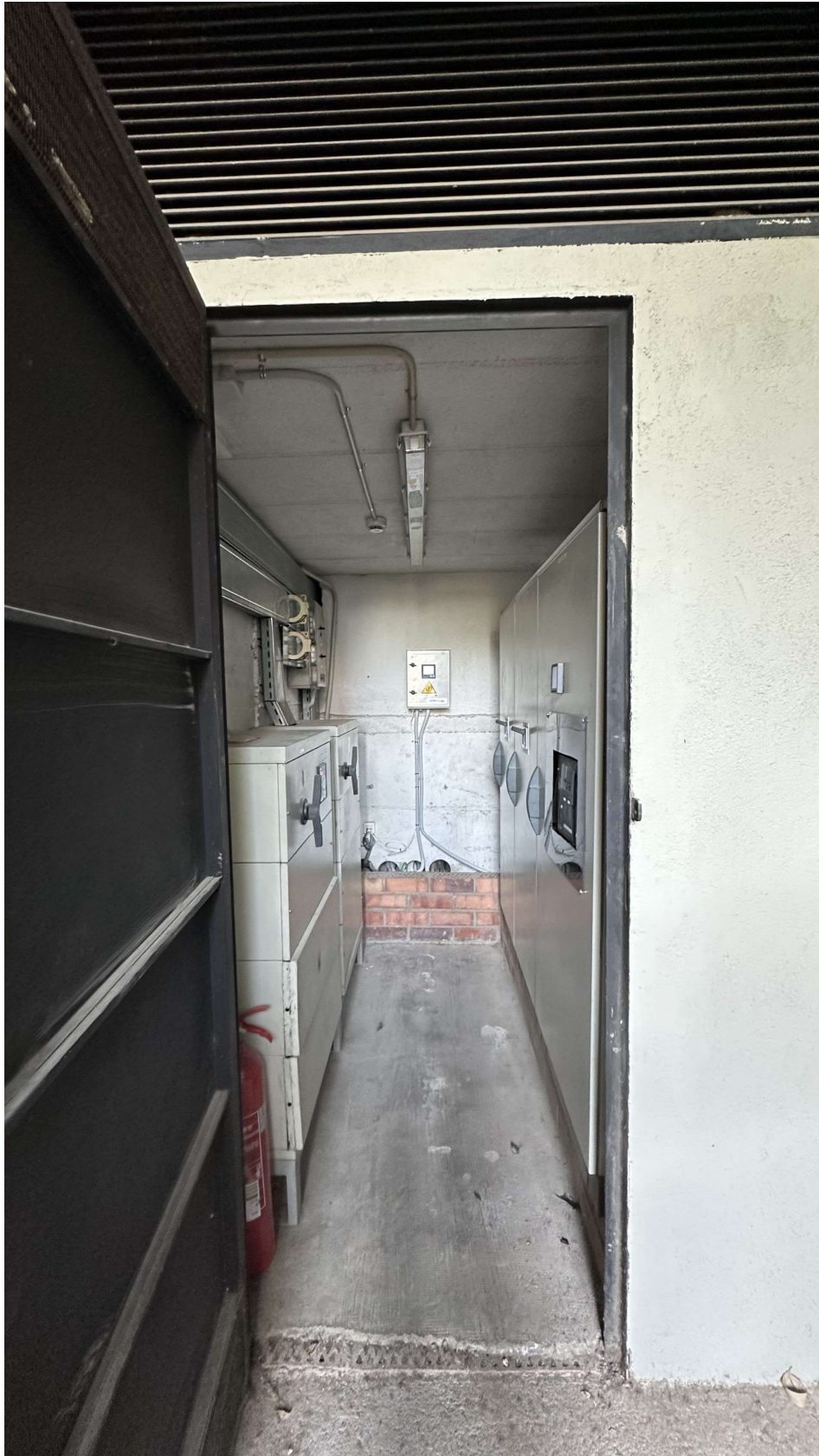
Imatge 5. Sala amb equips 0, 1, 2 i 3
