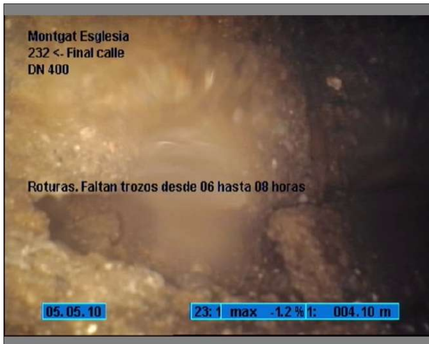
Foto: 2_6A 4,1m, Roturas. Faltan trozos desde 06 hasta 08 horas
