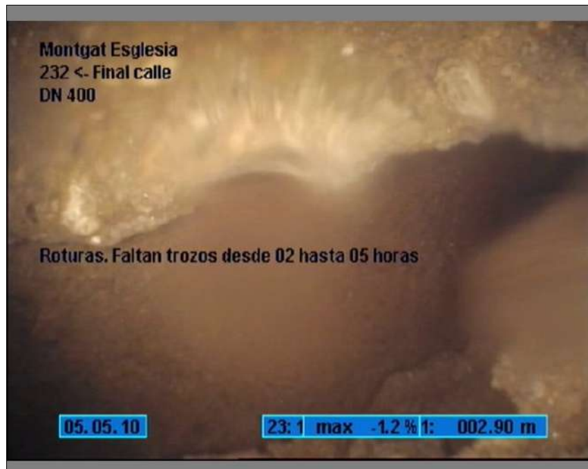
Foto: 2_5A 2,9m, Roturas. Faltan trozos desde 02 hasta 05 horas
