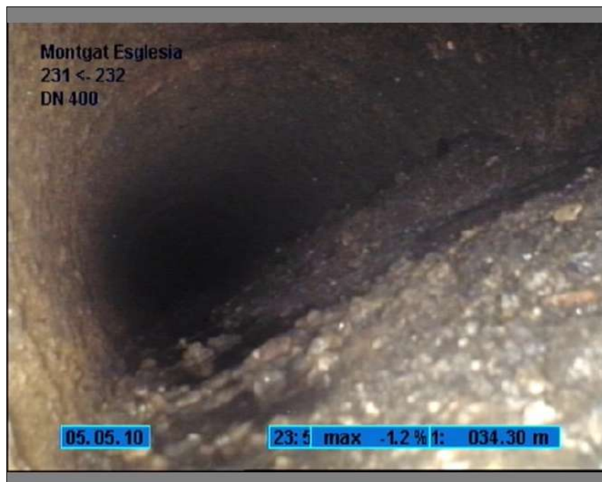
Foto: 3_2B 34,3m, La inspección no es posible sin limpiar l tubería
