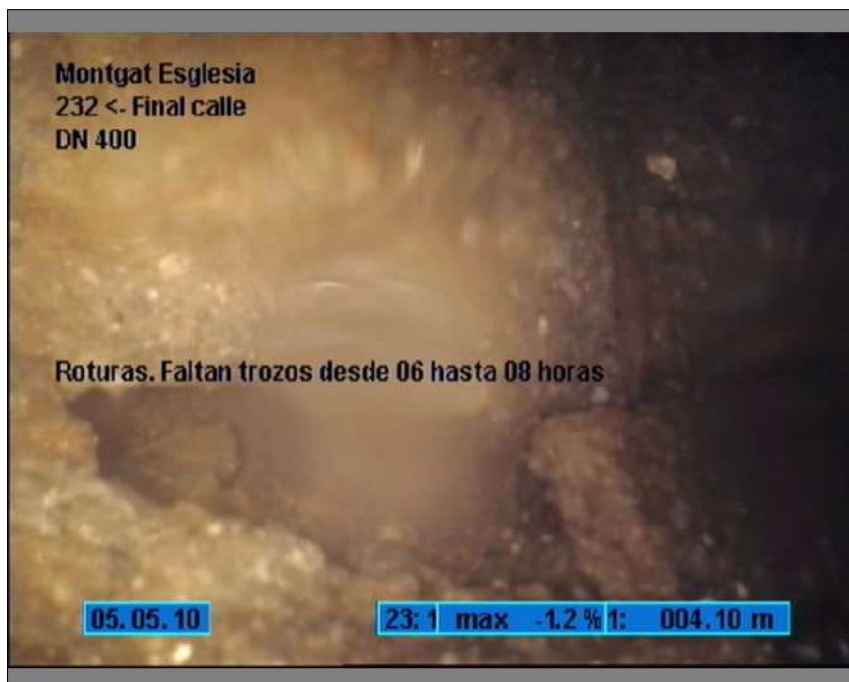
Foto: 2_6B 4,1m, Roturas. Faltan trozos desde 06 hasta 08 horas
