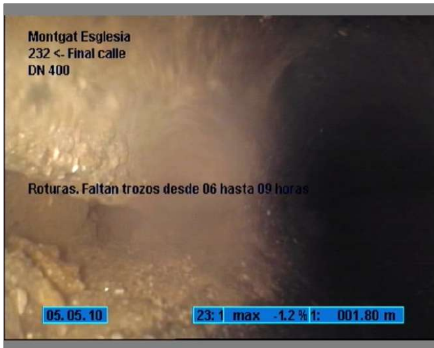
Foto: 2_4A 1,8m, Roturas. Faltan trozos desde 06 hasta 09 horas
