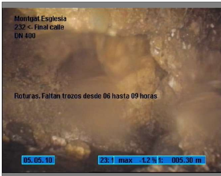
Foto: 2_7A 5,3m, Roturas. Faltan trozos desde 06 hasta 09 horas
