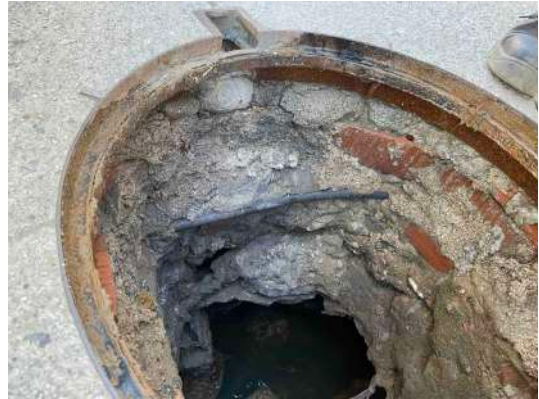
Cable en interior de pou 229
