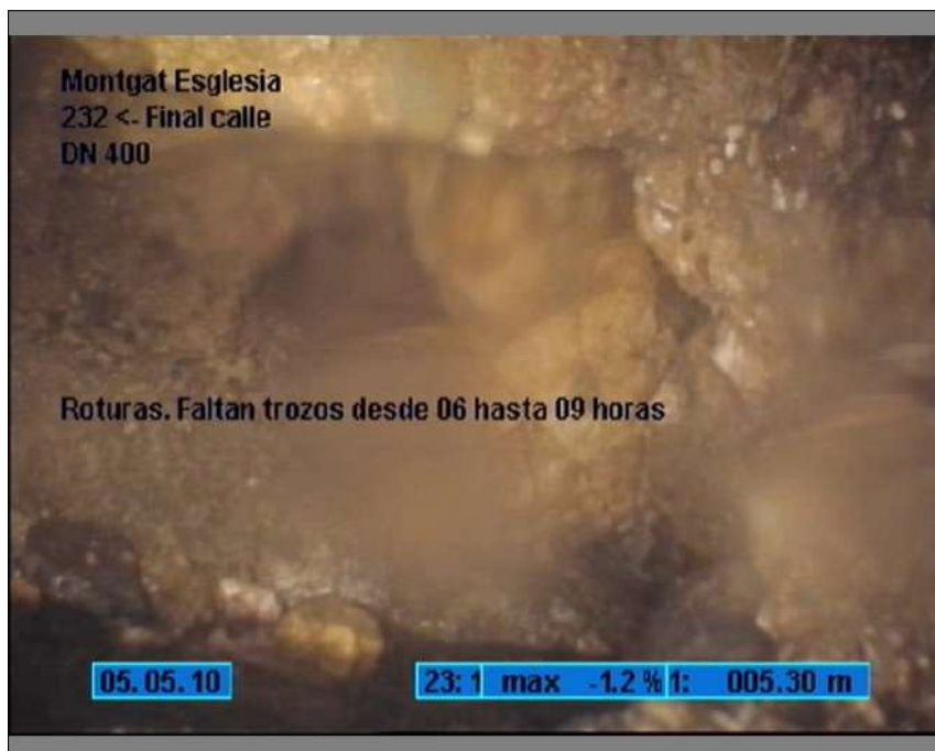
Foto: 2_7B 5,3m, Roturas. Faltan trozos desde 06 hasta 09 horas
