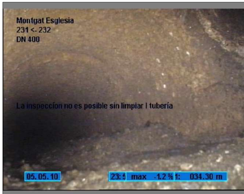
Foto: 3_2A 34,3m, La inspección no es posible sin limpiar l tubería
