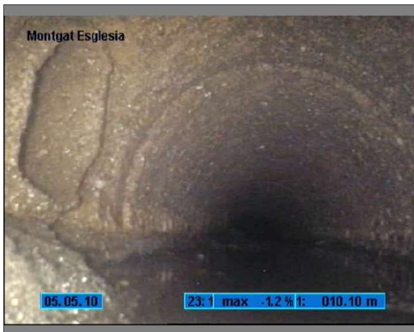
Foto: 4_2B 10,1m, La inspección no es posible sin limpiar l tubería
