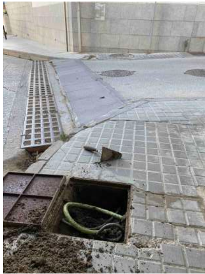
Arqueta on es localitza un cable
