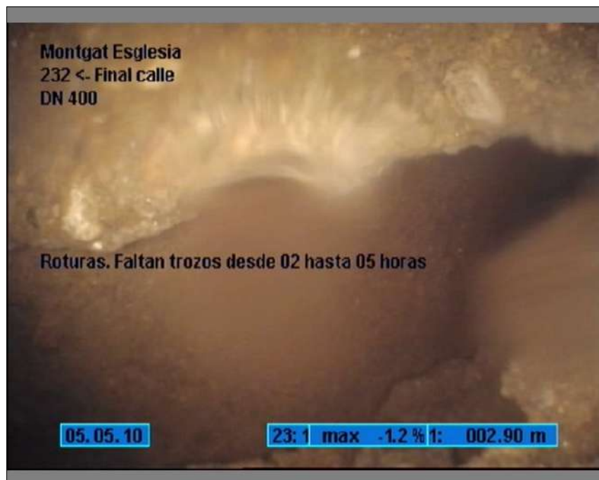
Foto: 2_5B 2,9m, Roturas. Faltan trozos desde 02 hasta 05 horas
