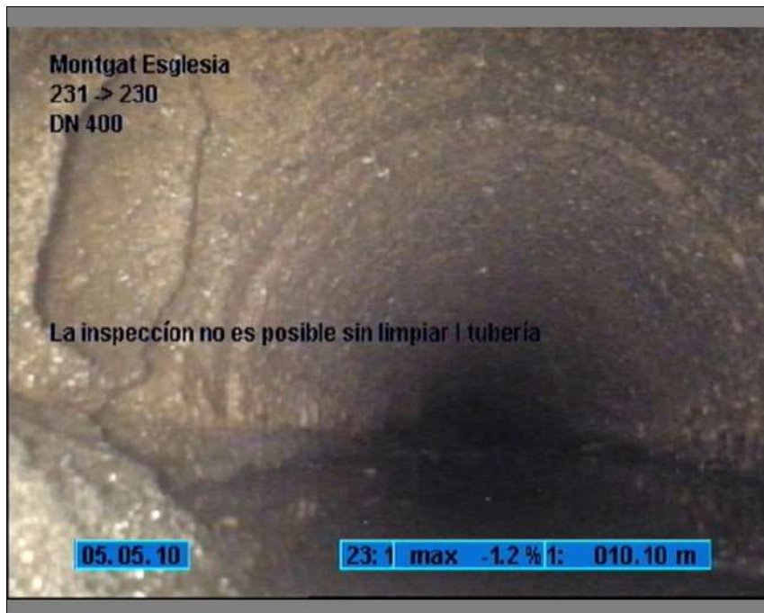
Foto: 4_2A 10,1m, La inspección no es posible sin limpiar l tubería
