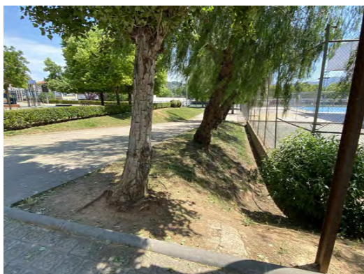
Imatge 04 - Desnivell entre la rampa d'accés i la tanca perimetral del recinte
