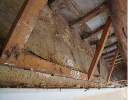
Imatge: F3. Degradació parament. Filtracions i humitat.
