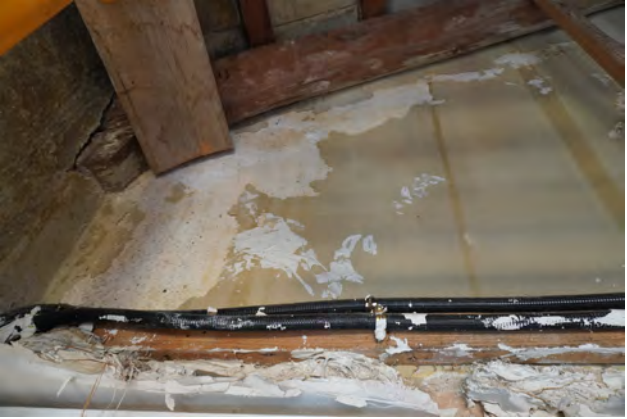
Imatge 10. Degradació de del revestiment
