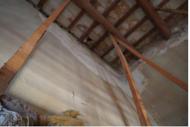
Imatge 12. Degradació de del revestiment
