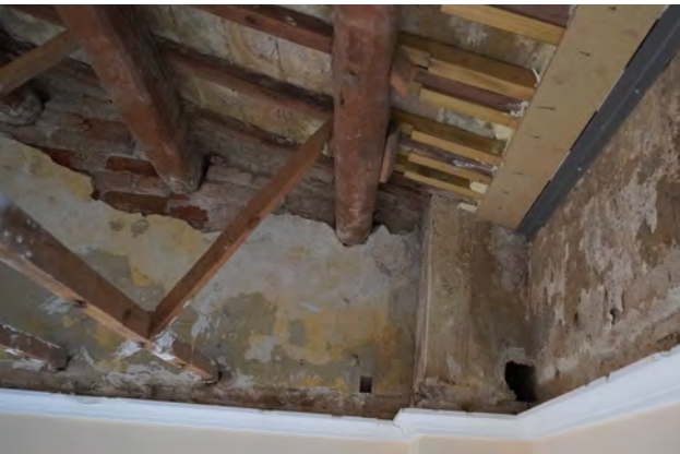
Imatge: F6. Degradació parament. Filtracions i humitat.
