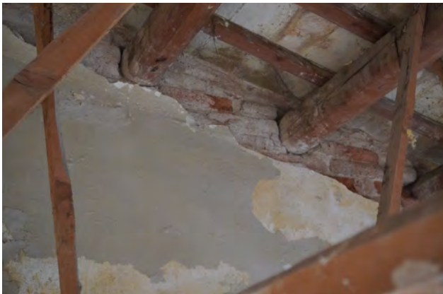
Imatge: F5. Degradació parament. Filtracions i humitat.
