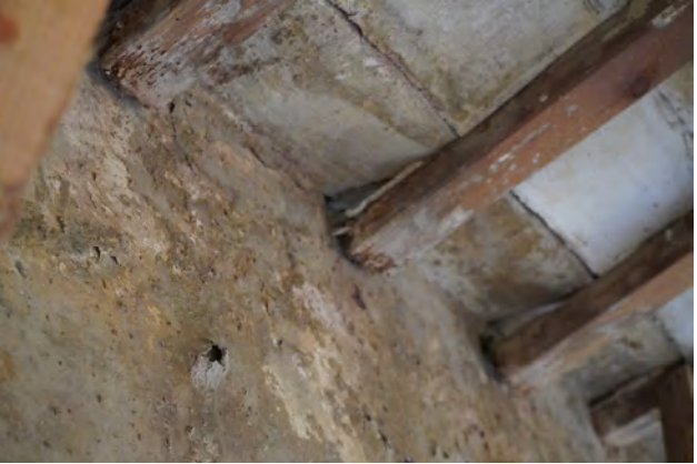
Imatge 7. Afectació caps llates
