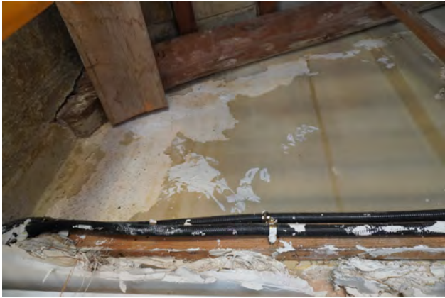
Imatge: F5. Degradació parament. Filtracions i humitat.
