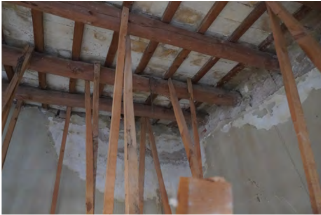
Imatge: F4. Degradació parament. Filtracions i humitat.
