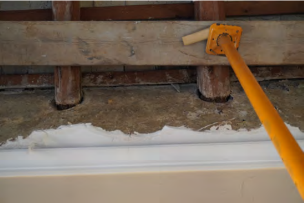
Imatge 2. Apuntalament caps bigues (A-06 - A10)
