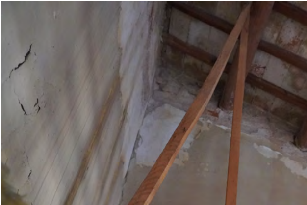
Imatge: F3. Degradació parament. Filtracions i humitat.
