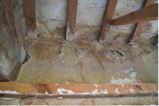
Imatge 11. Degradació de del revestiment
