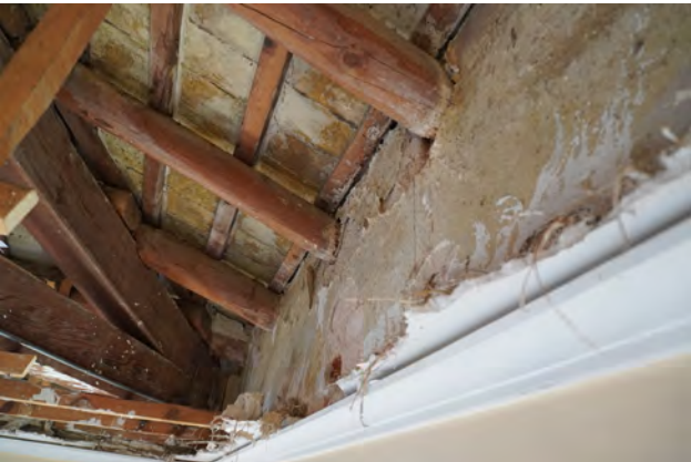
Imatge: F2. Degradació parament. Filtracions i humitat.
