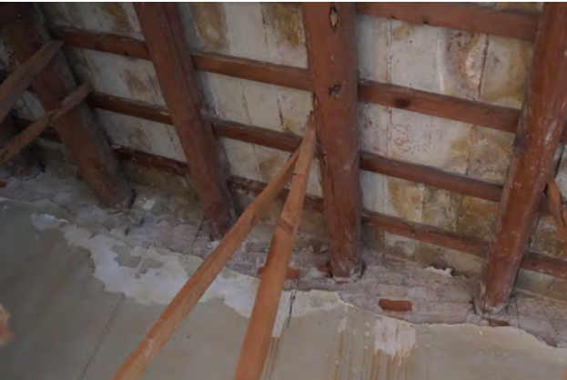
Imatge: F4. Degradació parament. Filtracions i humitat.
