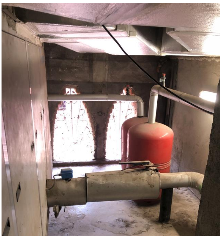
Figura 1: Imatge d'una de les màquines generadores de fred on s'observa la canalització superior dels ventiladors a coberta
