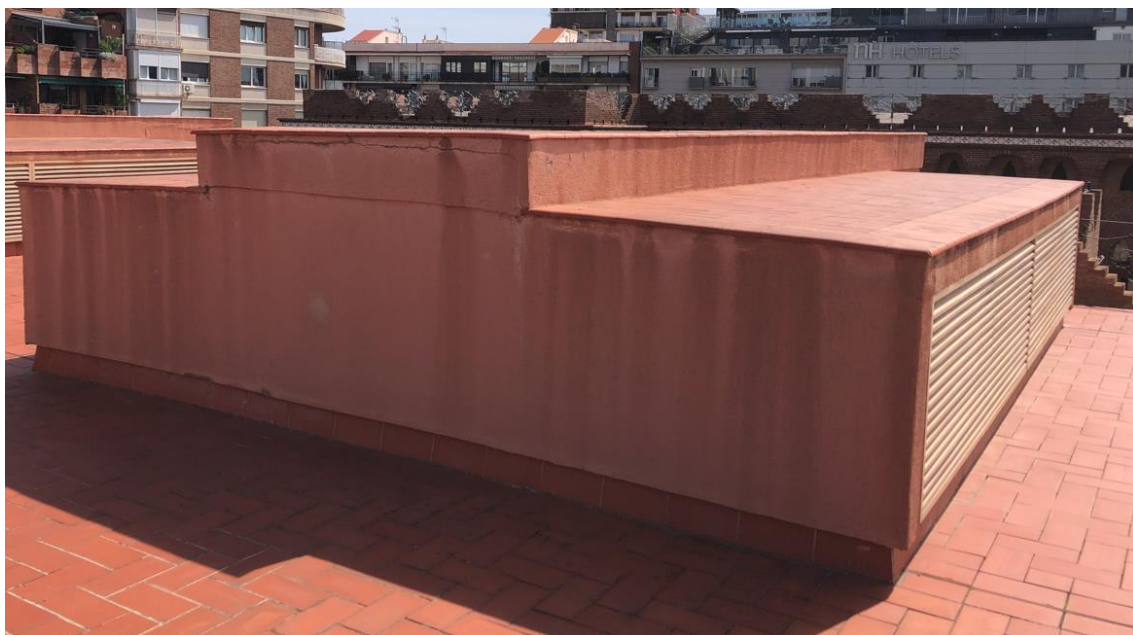
Figura 5: Estructura de ventilació sobre la refredadora.
