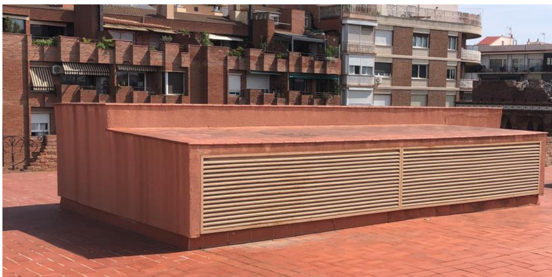
Figura 6: Estructura de ventilació del recuperador de calor en l'altra sala tècnica.
