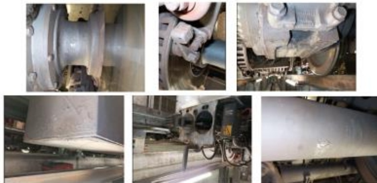
UT5: Timonería de freno, reductora, cofre ATP, motor de tracción, punto de levante de caja
