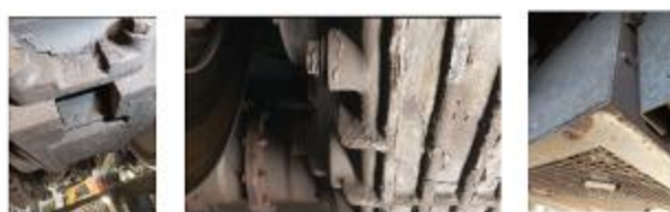
UT10: Caja CC63, reductora, cofre ATP, panel neumático
