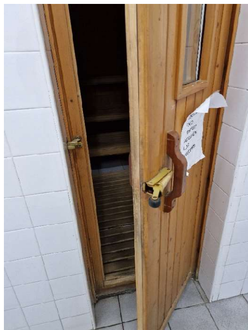
Imatge 9. Sistemes de tancament de les saunes a substituir.
