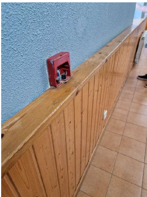
Imatge 8. Instal·lacions contra incendis en mal estat.
