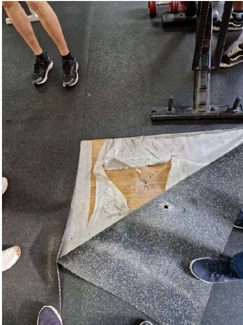
Imatge 4. Mal estat del paviment.
