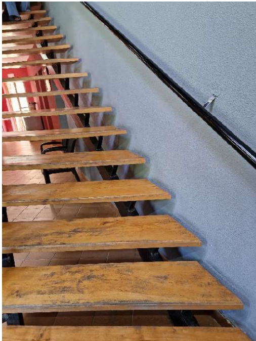
Imatge 6. Escala accés a planta 1 i passamà en mal estat.
