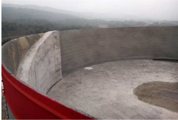
Rampa per fauna de formigó, un altre exemple, en aquest cas simple (no doble).
