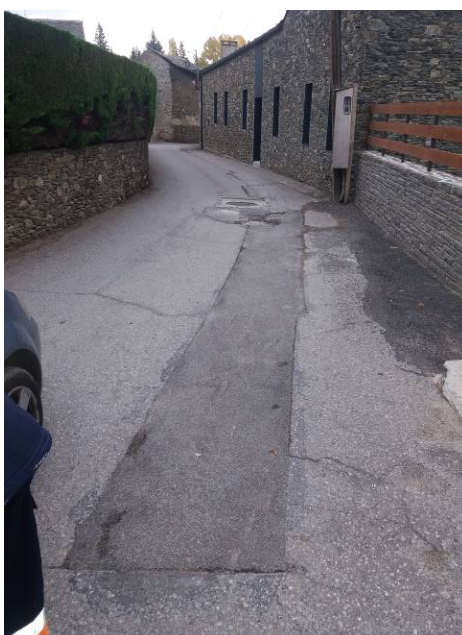
Vista de rasa de canonada d'aigua en carrer Roser, oberta per una reparació anterior
