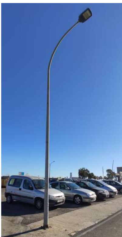
Imatge nº10. Bàcul a substituir
