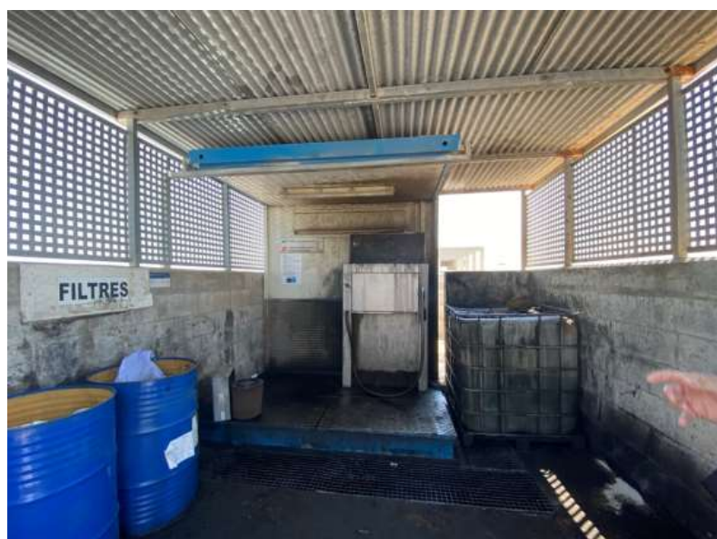
Imatge n°6. Zona recepció olis industrial usats.
