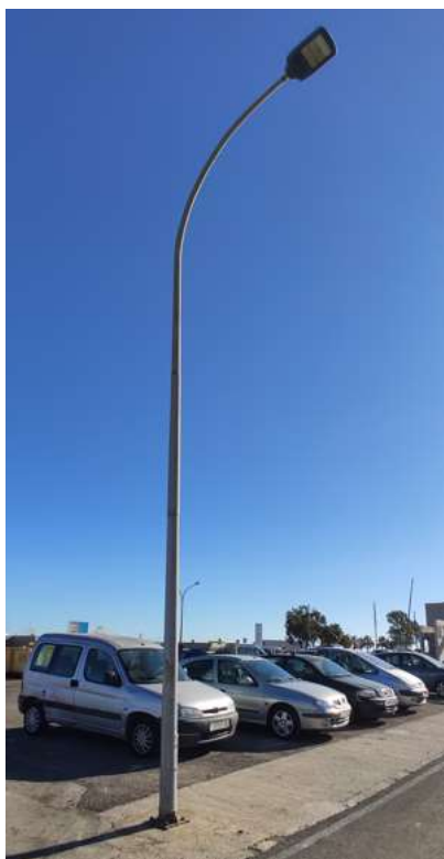
Imatge nº10. Bàcul a substituir
