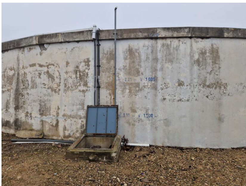
Arqueta de sortida del dipòsit d'aigua tractada
