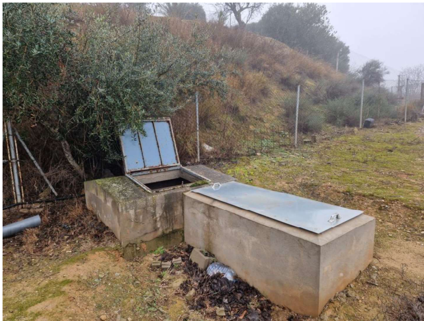
Arqueta d'entrada a l'ETAP
