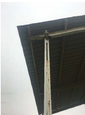
Oxidació de l'estructura.
