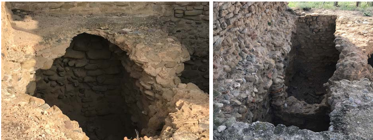
Figura 4. A l'esquerra detall de la zona sud de la coberta que conserva part de la volta de canó i on s'aprecia els problemes de disgregació de l'interior dels conditoria . I, a la dreta, detall de la zona nord on s'ha perdut totalment la coberta i podem veure l'acumulació de restes de runa al fons de les estances.
