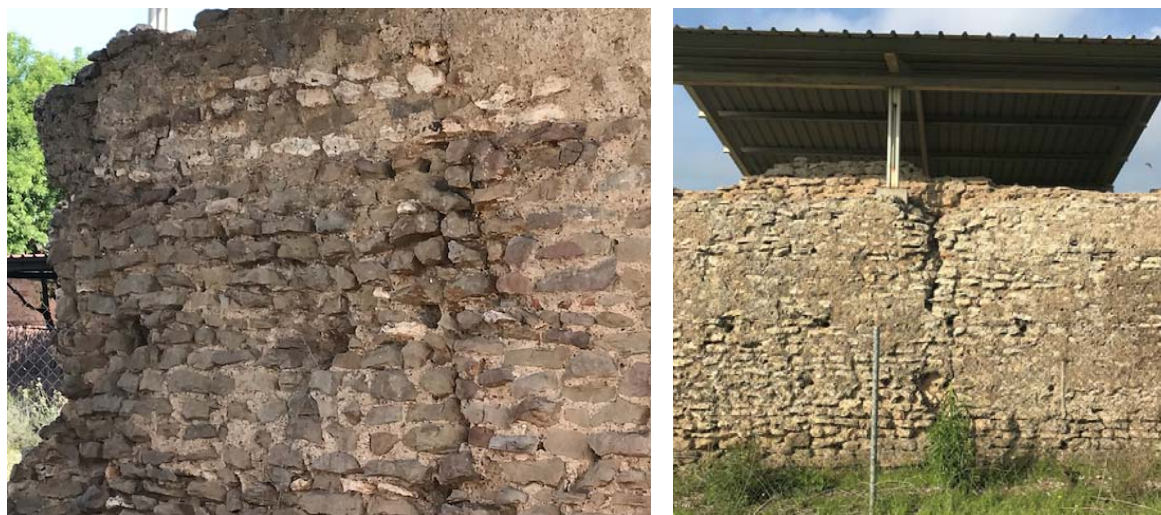
Figura 5. A l'esquerra detall del mur N on hi ha zones de pèrdua de l'argamassa de lligat. I, a la dreta, detall de l'esquerda vertical del mur N vista des de l'exterior
