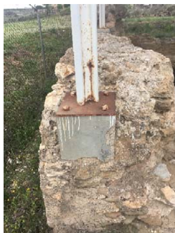
Oxidació de l'estructura.
