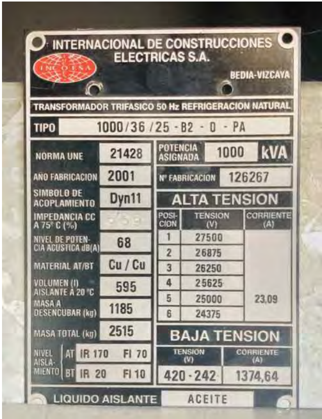
PLACA D'IDENTIFICACIÓ DEL TRANSFORMADOR DE L'ABONAT, A L'INTERIOR DEL CM.
