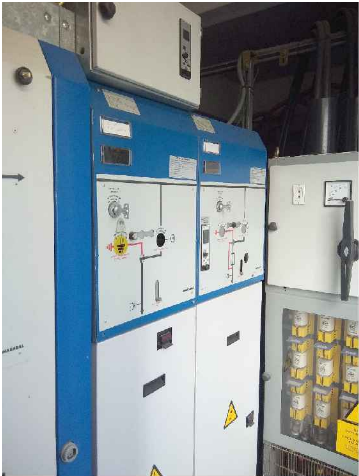
CABINA DE LÍNIA I RUPTO-FUSIBLE DE L'ABONAT, A MANTENIR.
