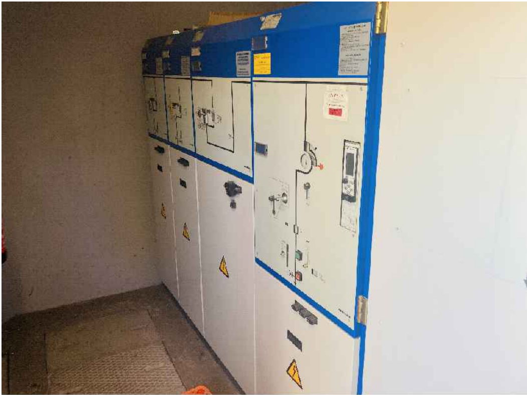
CABINES MT DE COMPANYIA I CABINA AUTOMÀTIC MT DE L'ABONAT, A DESMANTELLAR.
