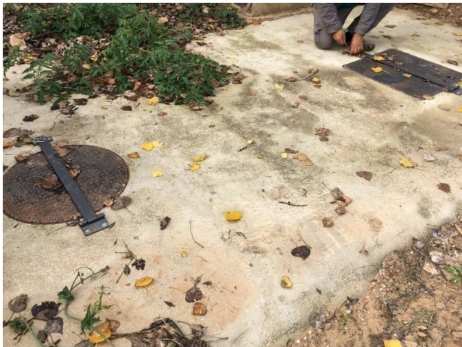
Fotografia 2 Arquera situació del pou Font de Badia. Font: Pla Director d'Aigua (Febrer de 2020)
