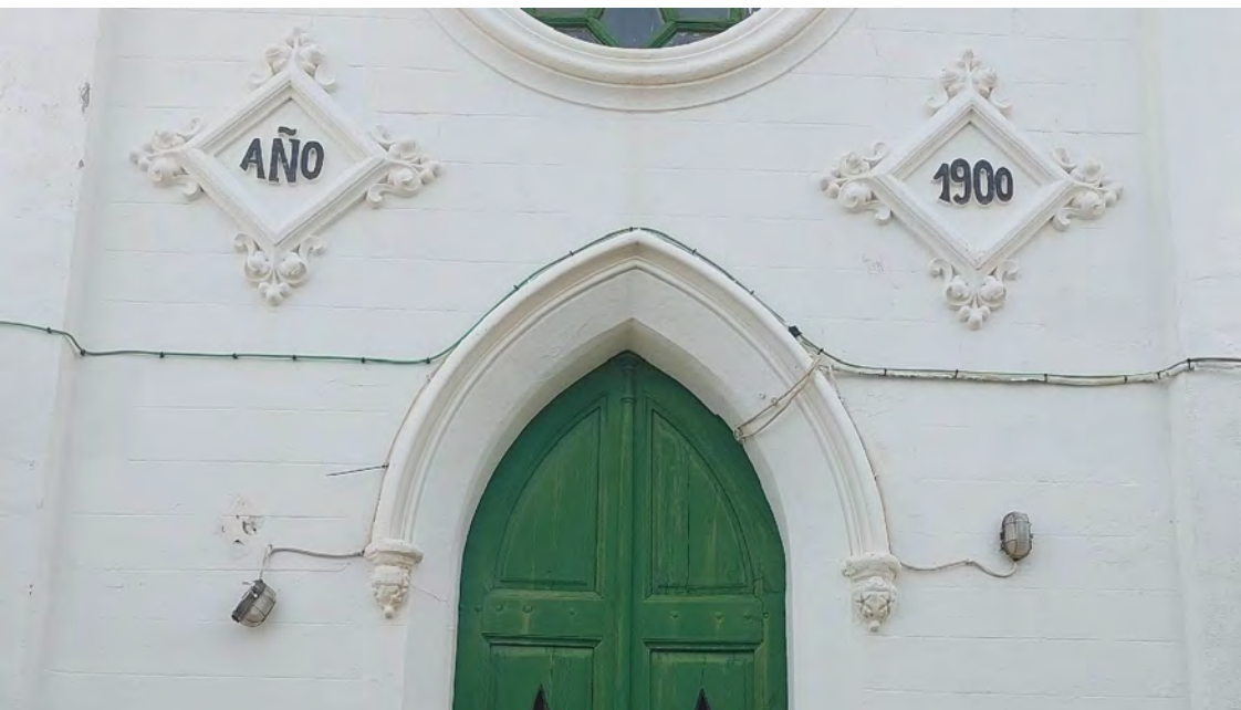
IMATGES DE L'ESTAT DEFICIENT DE LES INSTAL·LACIONS
