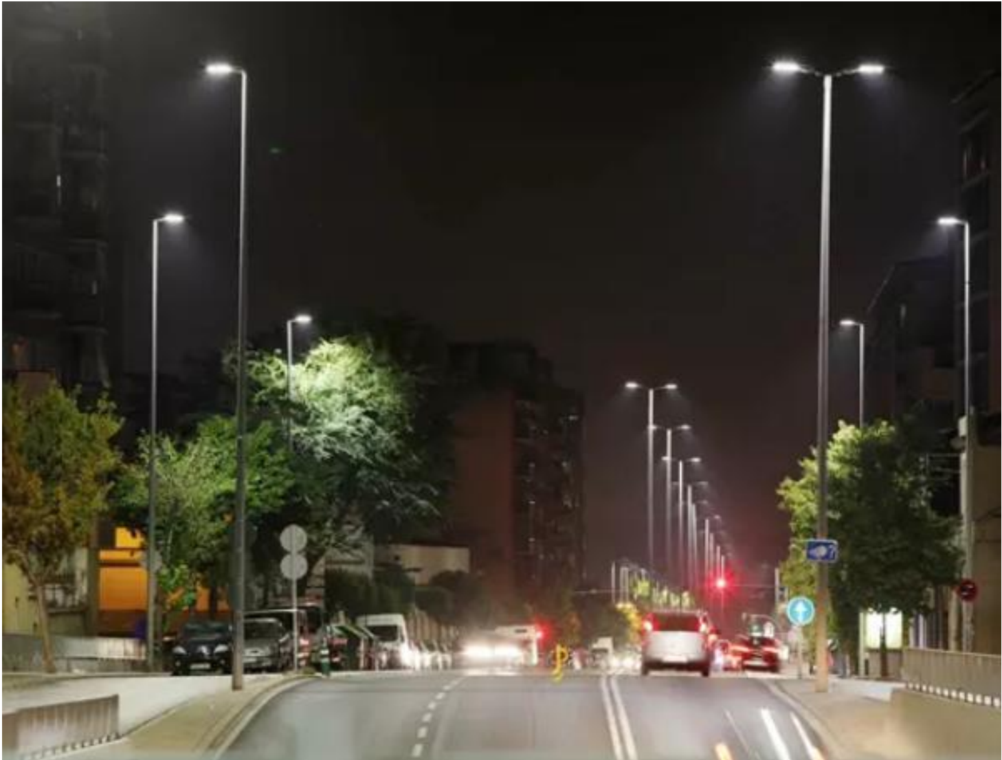
PROJECTE DE SUBSTITUCIÓ DE FANALS A SABADELL
