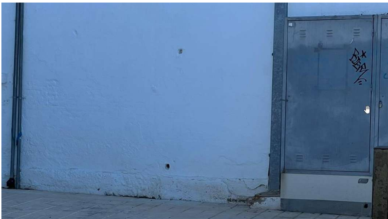
Imatge nº12. Armari connexió instal·lació elèctrica, façana est Antiga Llotja del Peix.
