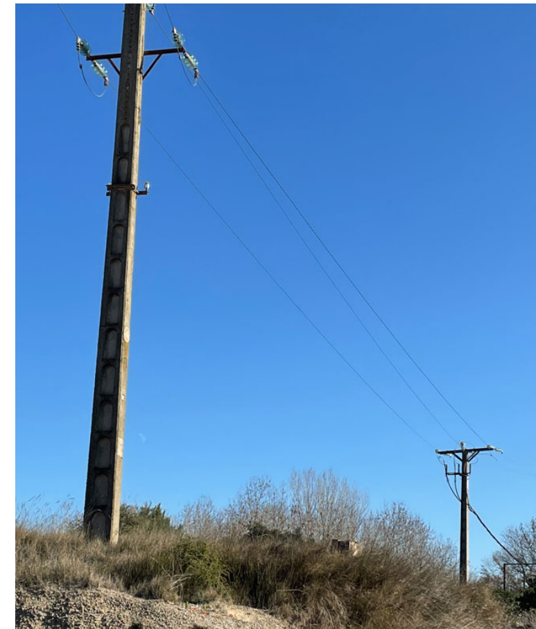
Línia elèctrica aèria de mitja tensió 25kV.
