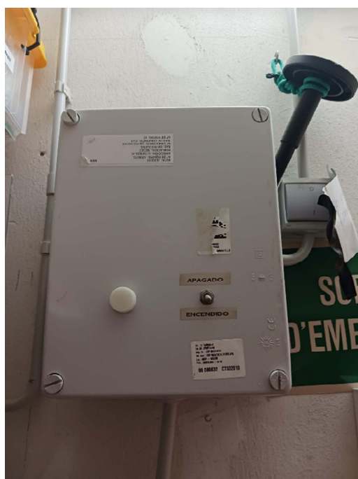
Figura 4. Quadre elèctric de la plataforma
