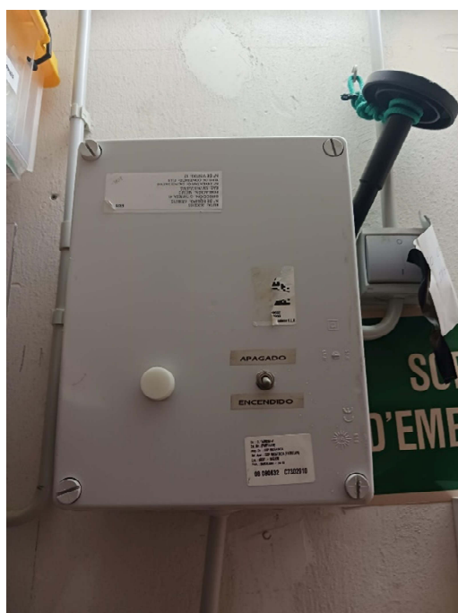
Figura 4. Quadre elèctric de la plataforma
