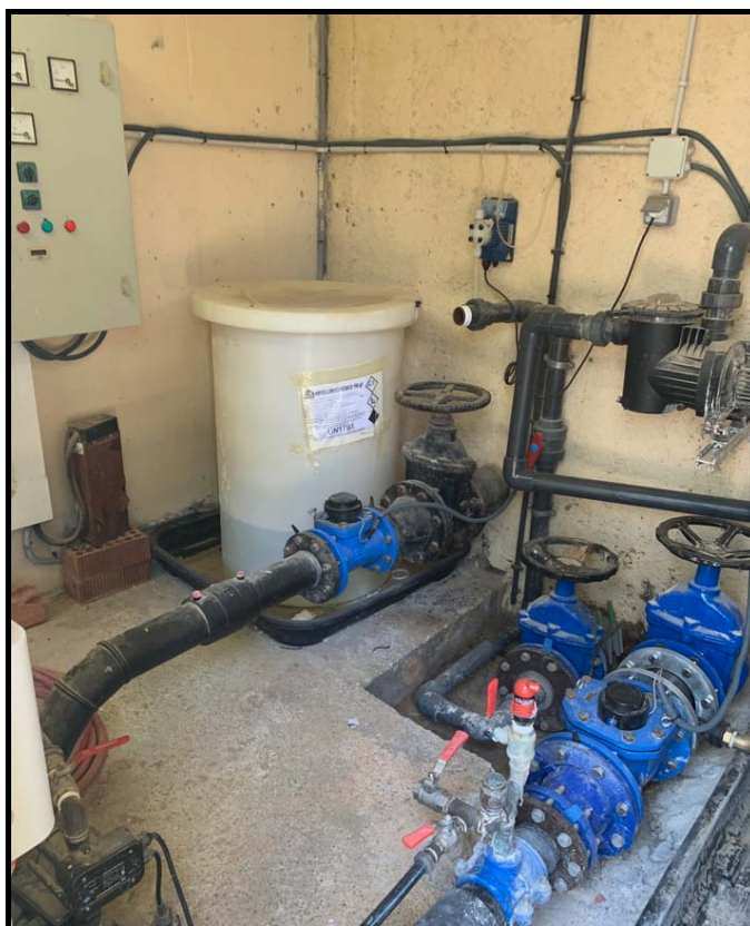
Imatge de l'interior de la caseta existent al Dipòsit de Fontanes
