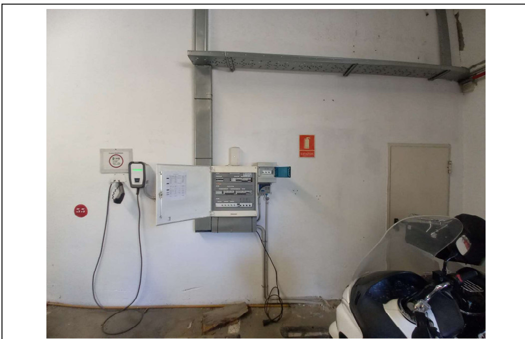
Àmbit quadre elèctric existent
