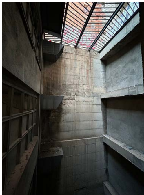
Vista dels pous de llum i de ventilació de l'aparcament amb afectacions de recobriment
