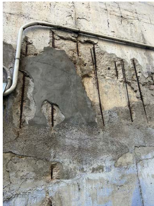
Degradació del recobriment del formigó a la zona de la rampa d'accés de l'aparcament
