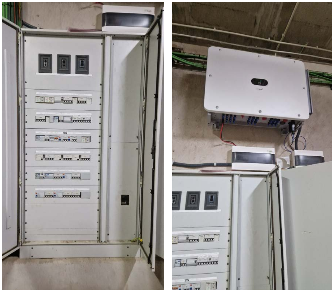
Imatge del quadre general on cal connectar i de l'inversor HUAWEI SUN2000-100KTL existent.
